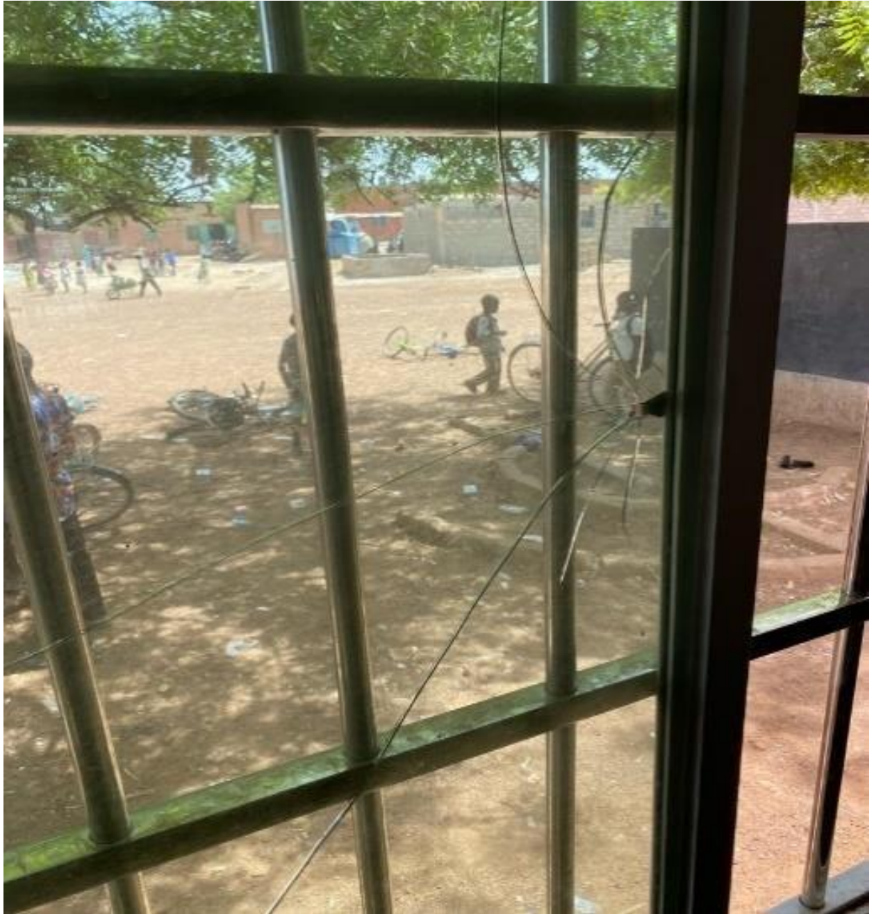
Vitres brisées à l'école primaire publique A de Koupèla au Secteur 3 avant réception (Centre-Est)
