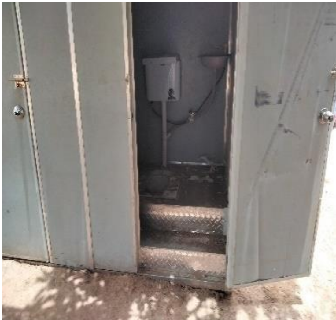
Photo des toilettes préfabriquées prises à l'école BOUNOUNA A dans la Commune de Banfora ( Cascades).
